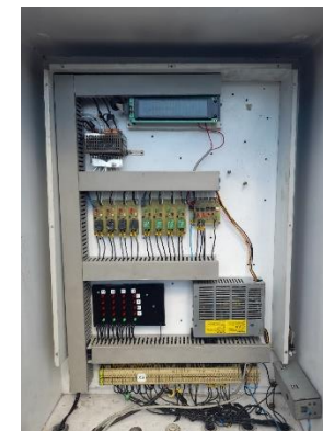
Figura 7. Vista del sistema de control
