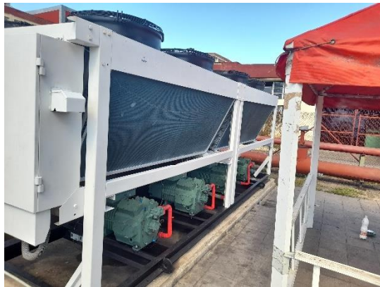
Figura 2. Vista general unidad enfriadora CHAW 2004.
