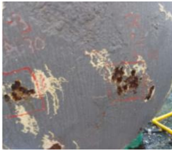
Figura 1 foto de afectación en el cabezal A zona 3
