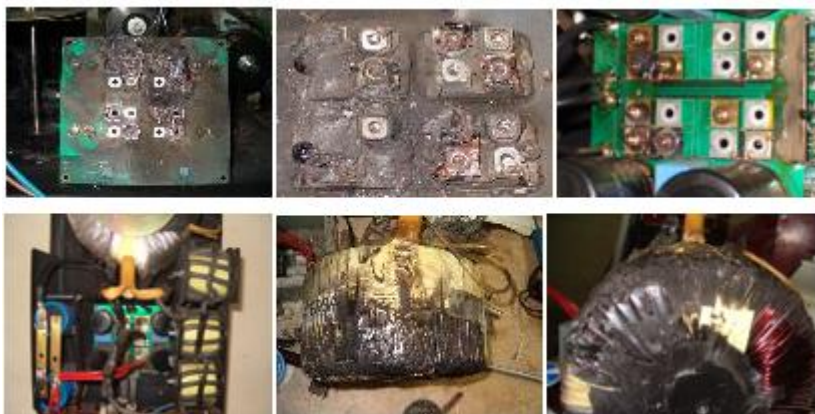
Fig. 3. Daños en los inversores TAUROS.
