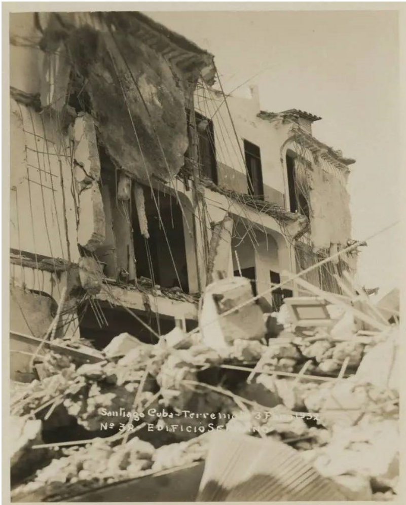
Imagen 2. Terremoto de 1932, Edificio Serrano en ruinas, Santiago de Cuba
