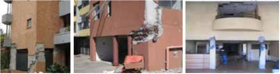
Figura 1. Fallo a cortante en columnas de hormigón de alta resistencia durante el sismo de Chile 2010. Fuente: (Hayes & McCabe, 2014)
